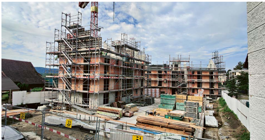
Blick auf die Baustelle. In zwei Mehrfamilienhäusern werden aktuell zwölf Wohnungen gebaut.
